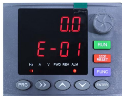
图3-4 加速中过流故障报警显示
